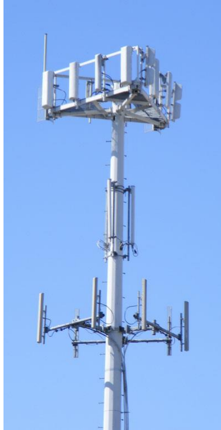
Figure 6 Σταθμός βάσης κινητής τηλεφωνίας
