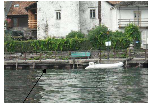
Opere di ingegneria classica, chiuse, sulla sponda - Palancolata di metallo (foto M. Ciampitiello)
