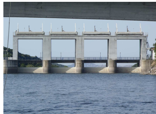
Paratoie diga (foto M. Ciampittiello)
