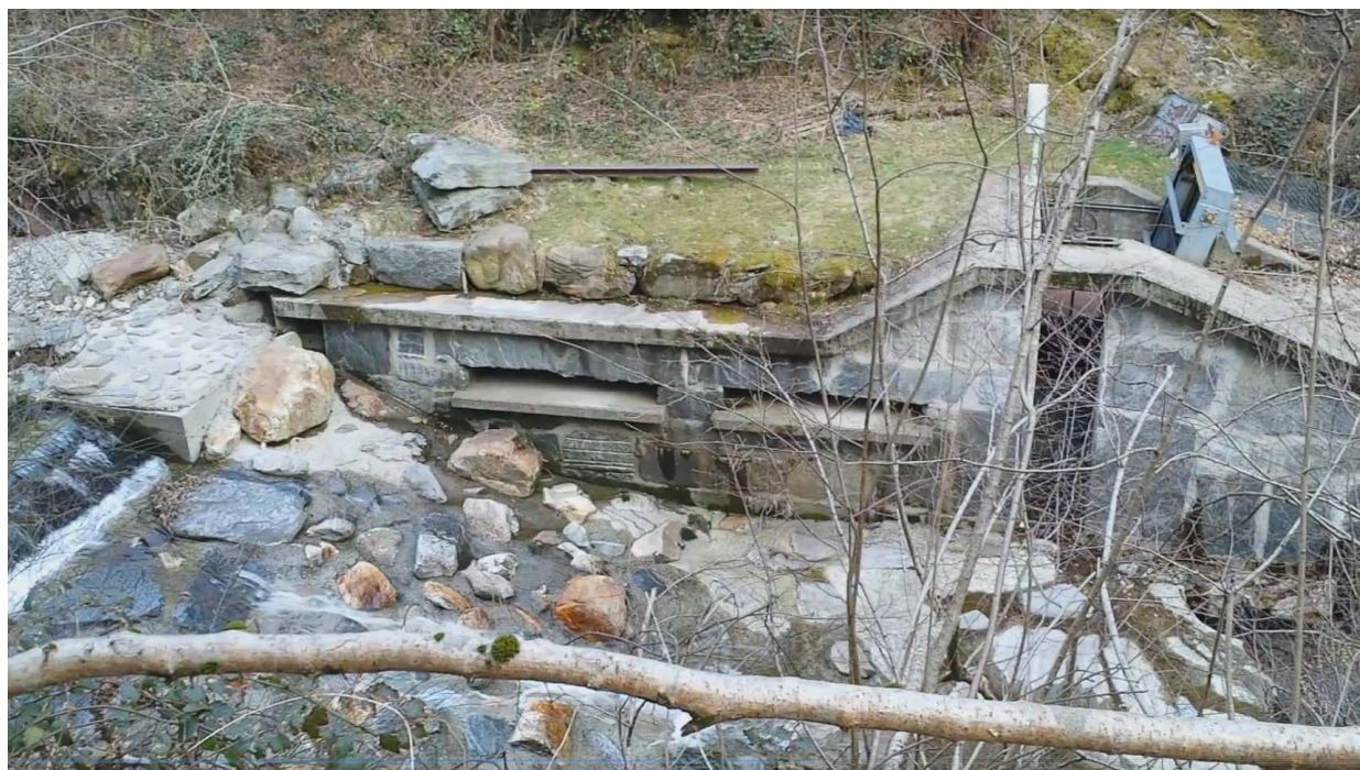
Figura 12. Sito di "Scareno". Dissabbiatore e vasca di carico. Sono visibili gli sfioratori laterali e la paratoia per la regolazione ed il controllo delle portate.
