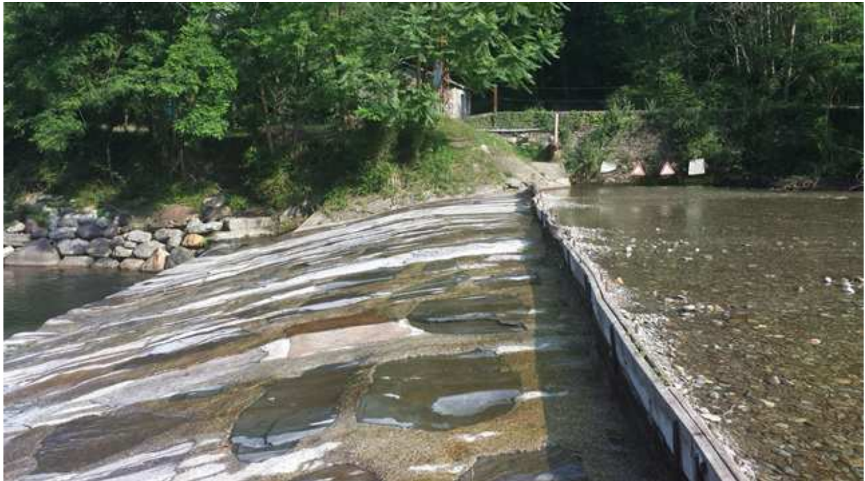
Figura 5. Sito di "Ramello". Vista della traversa e della sponda orografica destra. La presa di alimentazione del canale di derivazione è posta in corrispondenza dei cartelli di pericolo visibili. In questa posizione è presente anche la soglia per il rilascio del DMV. Entrambi questi elementi sono occultati alla vista.
