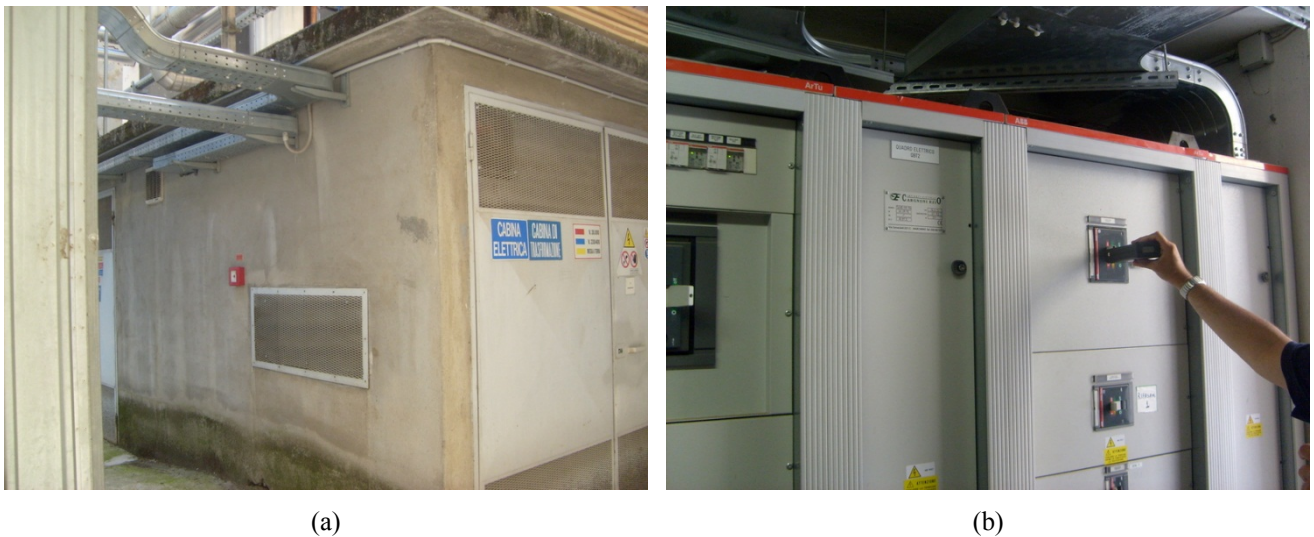
Figura 37 – (a) Cabina dei trasformatori MT/BT; (b) Locale quadri
