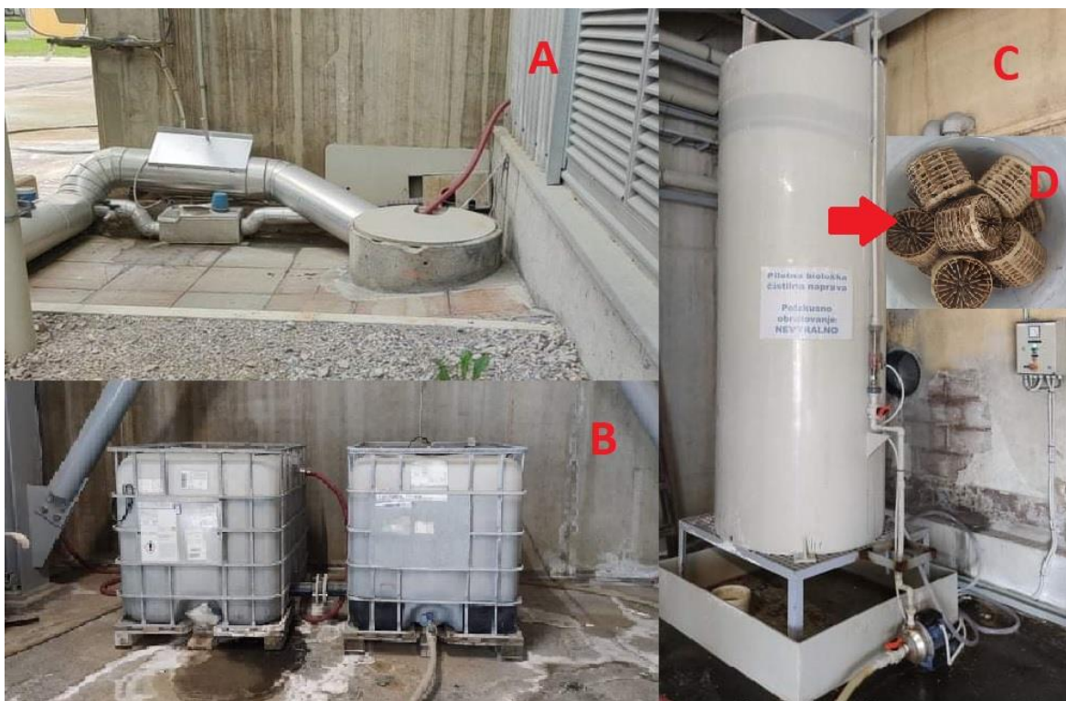
Slika 3-6: Celotna izvedba pilotne BČN: mesto, kjer je nameščena potopna črpalka (A), zbirne posode (B), kolona (C), nosilci znotraj kolone (D).
