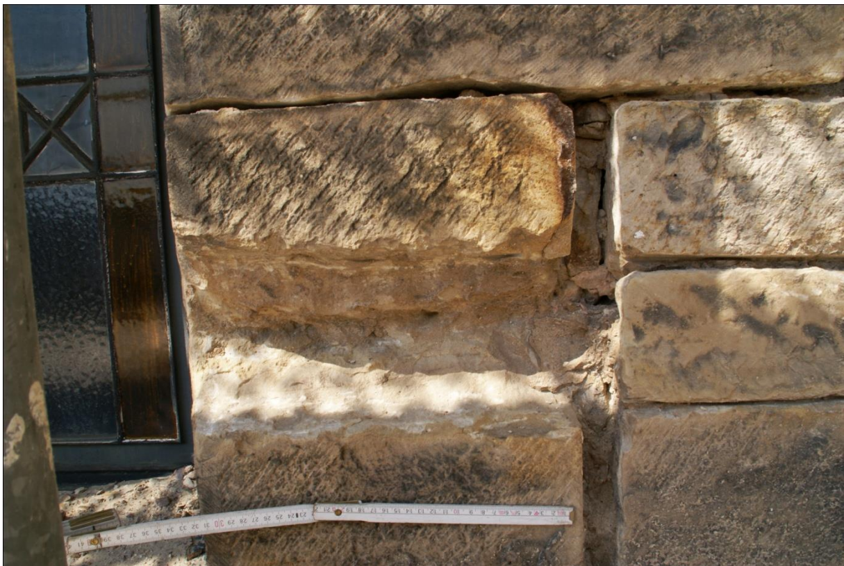
Abb. 4: Tief aufgeschnittene Fugen an der südlichen Hochschiffwand (Foto: A. Priesters, 05/2011)
