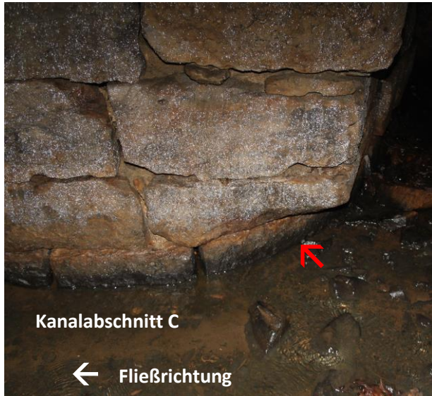
Abb. 18: Einmündung in den Kanalabschnitt C, abgerundete oder ausgewaschene Steinschicht (roter Pfeil), (Foto: J. Eberhard, 01/2014)
