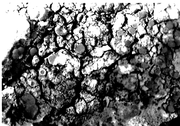
Fig.8.- Hormigón del Garum (BC-17). Colonización masiva de líquenes en la superficie.
