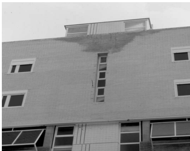
Figura 13.- Filtración en cubierta plana.
