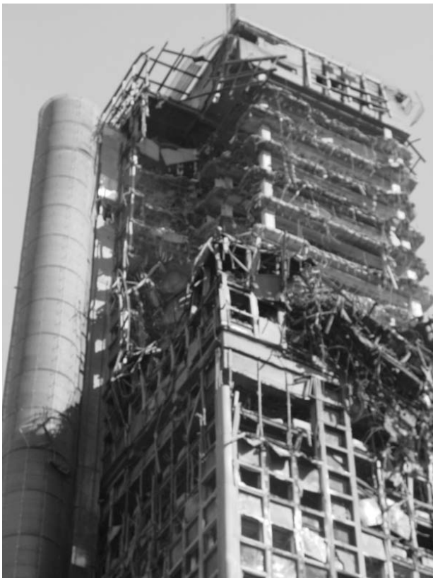
Figura 16.- Edificio Windsor después del fuego.
