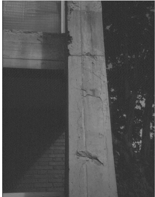
Figura 17.- Estructura de hormigón vista afectada por agentes meteorológicos.
