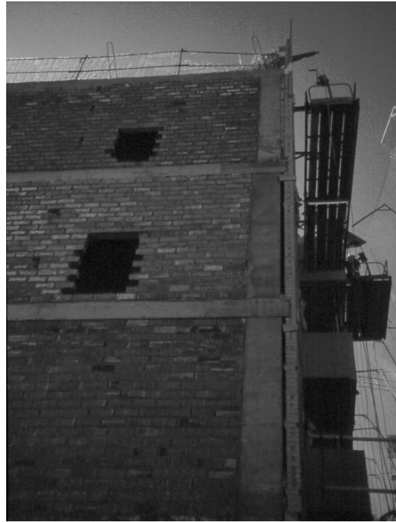
Figura 6.- Hoja de 1/2 pie de ladrillo apenas apoyada en estructura de hormigón.
