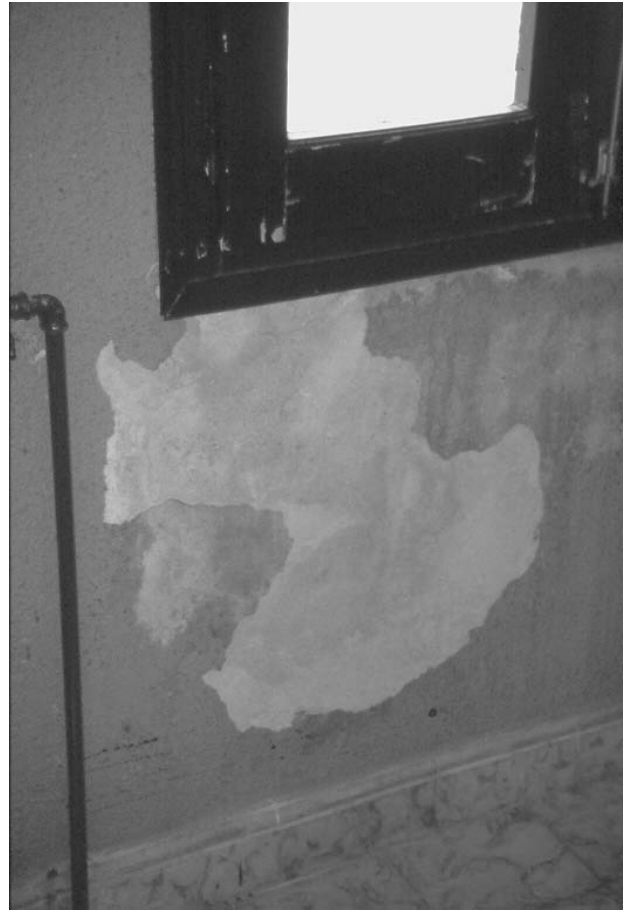
Figura 12.- Filtración por vierteaguas de ventana.
