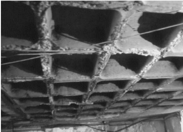
Figura 15.- Forjado de hormigón afectado por fuego.
