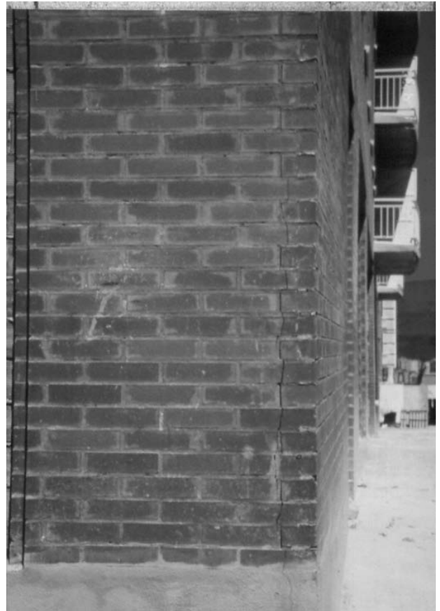
Figura 9.- Grieta en esquina producida por pandeo de pilar.
