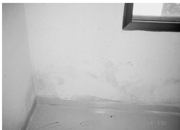
Figura 11.- Humedades de condensación superficial interior por fachada ligera sin aislamiento suficiente.
