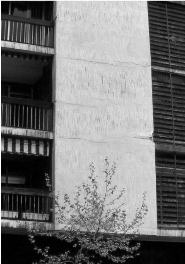
Figura 8.- Grietas producidas por flechas de vigas de borde.
