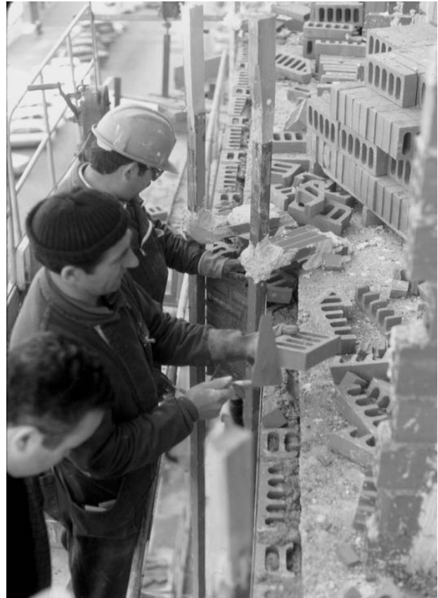
Figura 23.- Producción excesiva de escombros.
