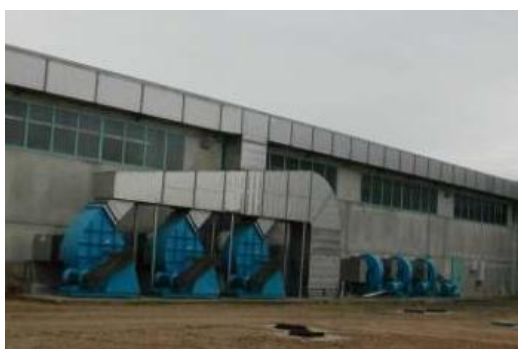
Figura 6.5 (a) Sistema di aspirazione.
