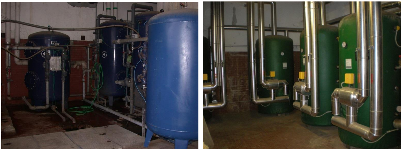
Figura 2.16a-b – Vista delle unità di trattamento dell'acqua e dei bollitori in centrale idrica [9].
