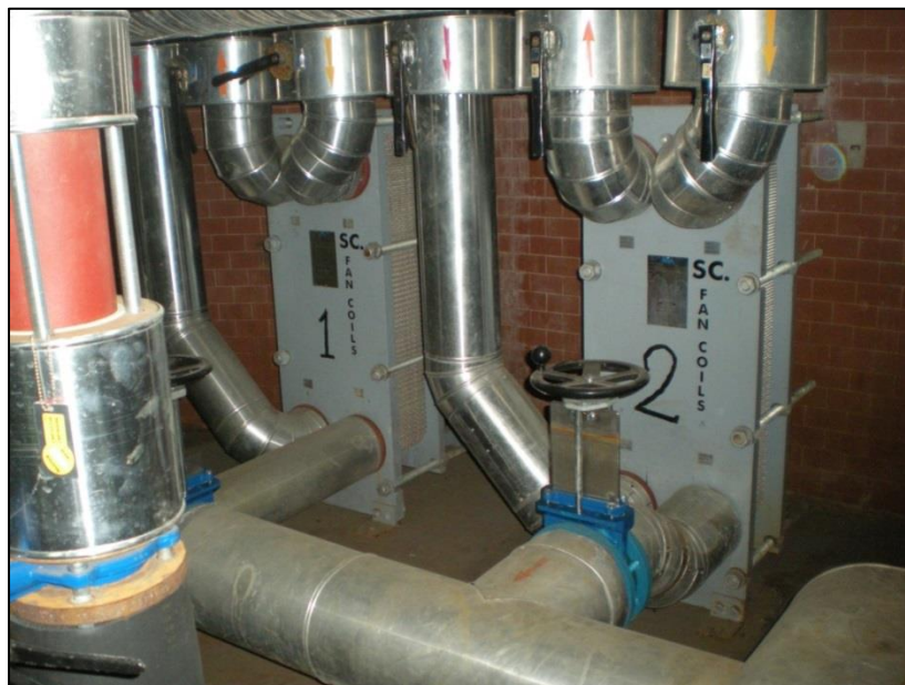
Figura 2.12 – Vista degli scambiatori del circuito fan-coil.
