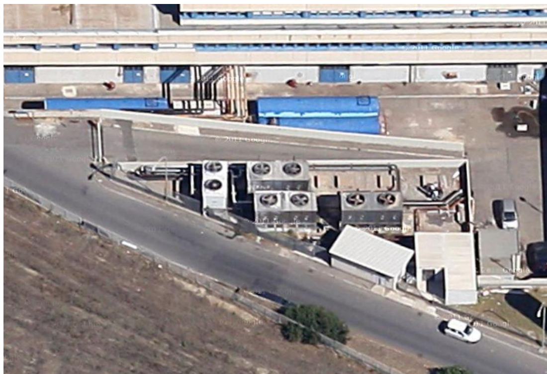
Figura 2.19 – Vista aerea delle torri evaporative.
