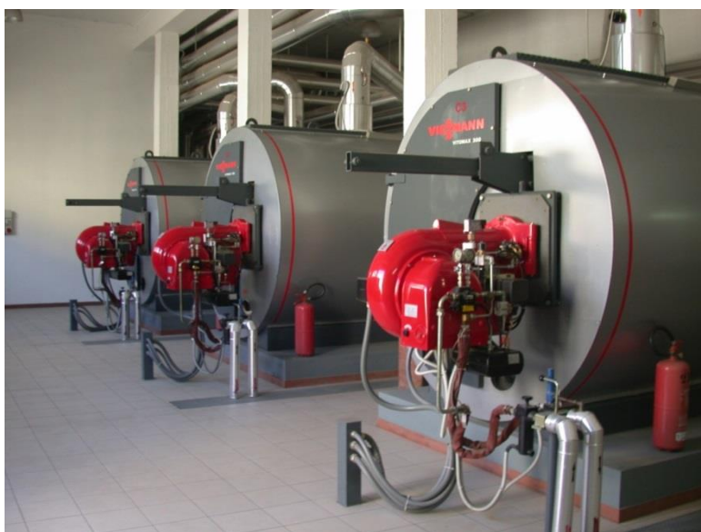
Figura 2.10 – Vista delle 3 caldaie nella centrale termica [9].
