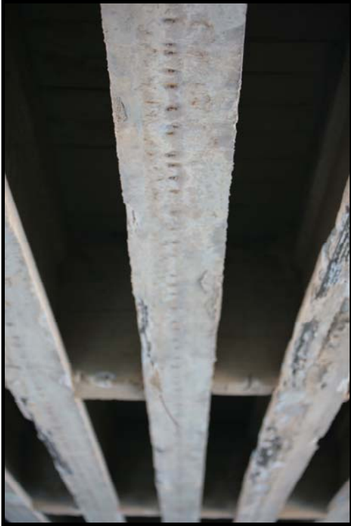
Foto 6.35: Manifestazioni di degrado presenti in mezzeria dell'elemento E 11
