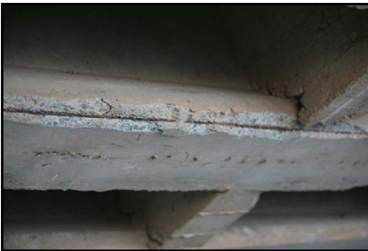
Foto 6.30: Manifestazioni di degrado presenti nell'estremità sx dell'elemento E 10
