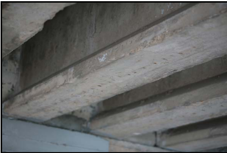
Foto 6.10: Manifestazioni di degrado presenti nell'estremità sx dell'elemento E 2
