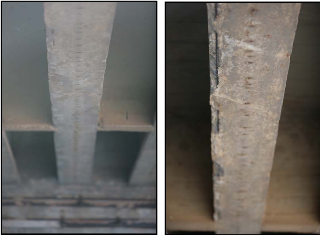
Foto 6.11, Foto 6.12: Manifestazioni di degrado presenti nell'estremità dx e in mezzeria dell'elemento E 3
