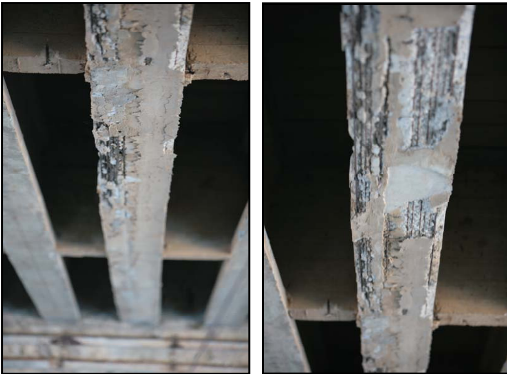
Foto 6.28, Foto 6.29: Manifestazioni di degrado presenti nell'estremità dx, in mezzeria dell'elemento E 10
