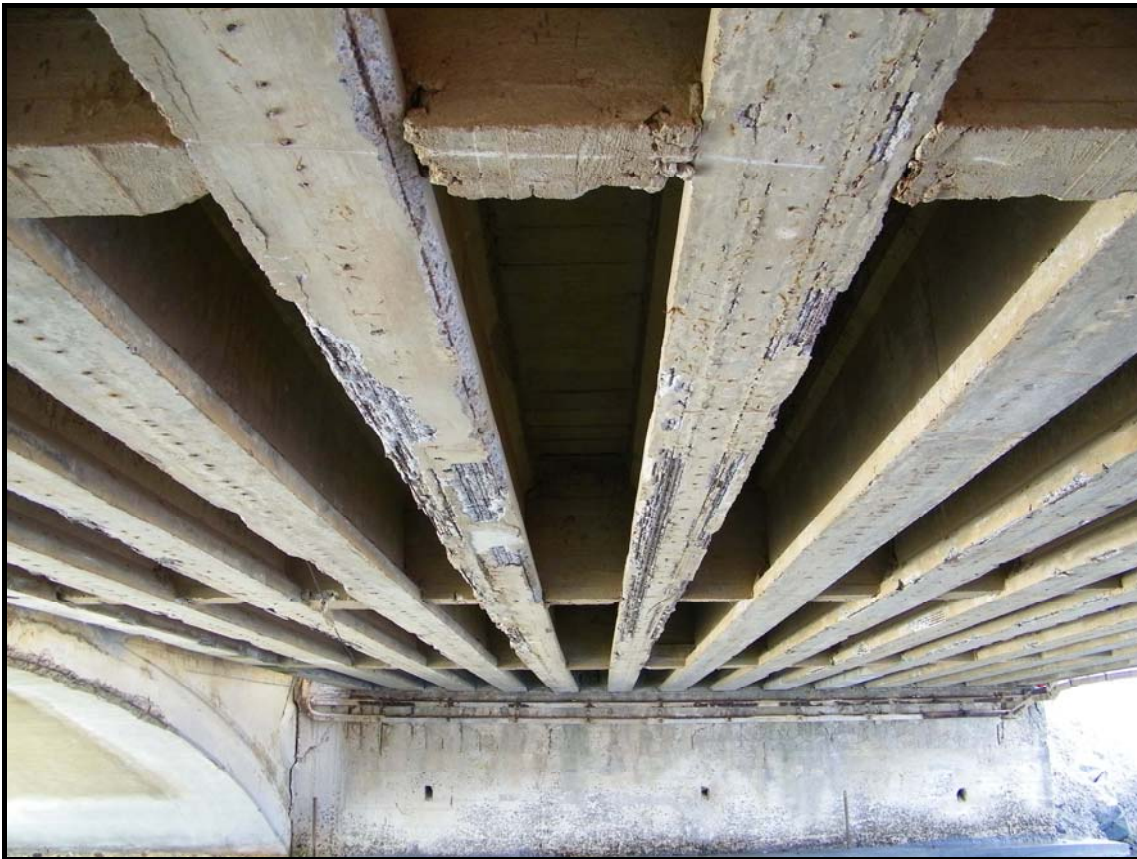
Foto 6.3: Stato di degrado sulle travi costituenti l'impalcato
