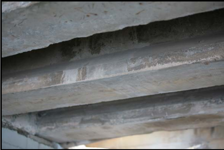
Foto 6.38: Manifestazioni di degrado presenti nell'estremità sx dell'elemento E 13
