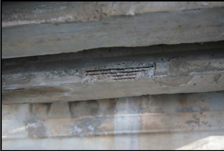
Foto 6.41: Manifestazioni di degrado presenti nell'estremità sx dell'elemento E 14
