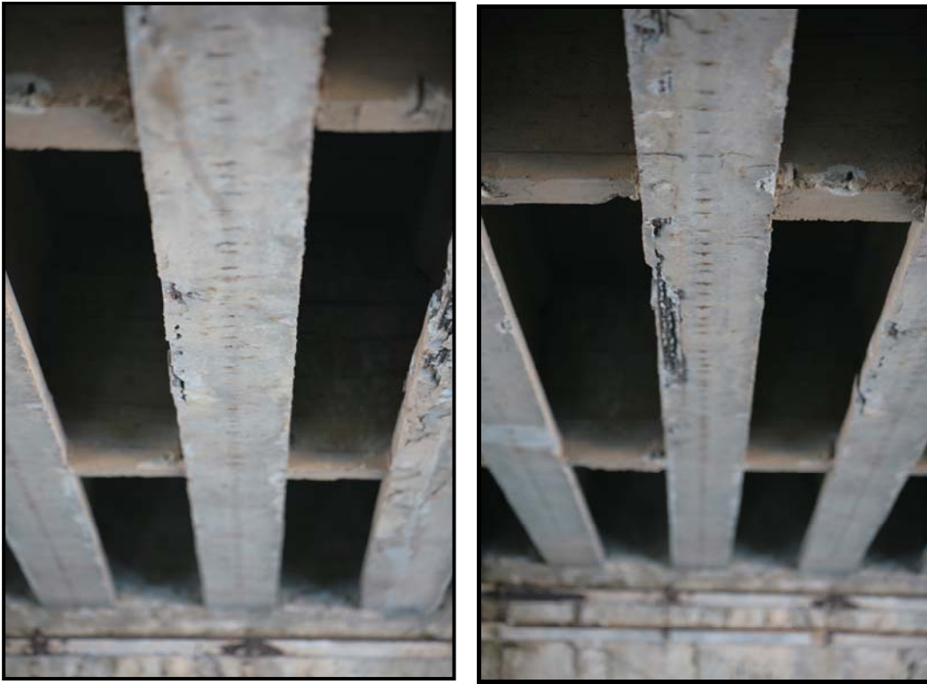
Foto 6.31, Foto 6.32: Manifestazioni di degrado presenti nell'estremità dx dell'elemento E_{11} e dell'elemento E_{12}
