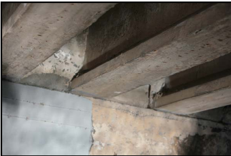
Foto 6.13: Manifestazioni di degrado presenti nell'estremità sx dell'elemento E 3
