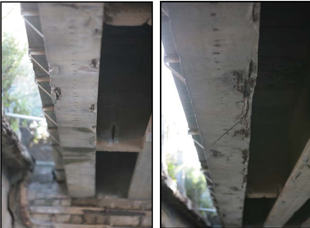
Foto 6.39, Foto 6.40: Manifestazioni di degrado presenti nell'estremità dx e in mezzeria dell'elemento E 14
