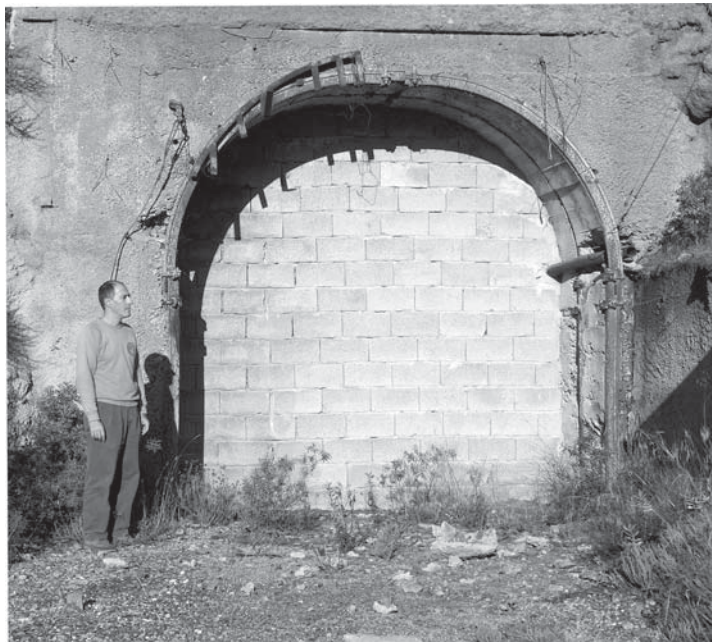
Figura 6. Imbocco di galleria mineraria completamente murato.
