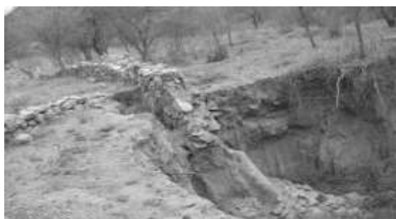
Foto N° 2 Se observa la cárcava CIIa que ingresó a la Plaza destruyendo la pared, y parte de la obra de prevención
