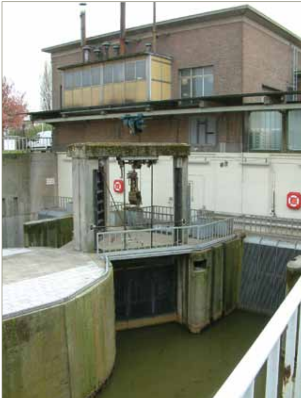
figuur 40: Pompgemaal Verlegde Schijns met dispositief reservepomp
