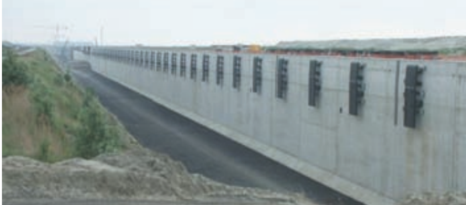
Zicht op een stuk van de 5,3 km lange kaaimuur van het Deurganckdok in aanbouw. De muren zijn 30 m hoog. De zwarte 'asfaltweg' helemaal onderaan is de erosiebescherming aan de teen van de kaaimuur. De zwarte platen op de muur zijn de fenders ( http://upload.wikimedia.org/wikipedia/commons/5/58/Kaaien_deurganckdok.jpg )
