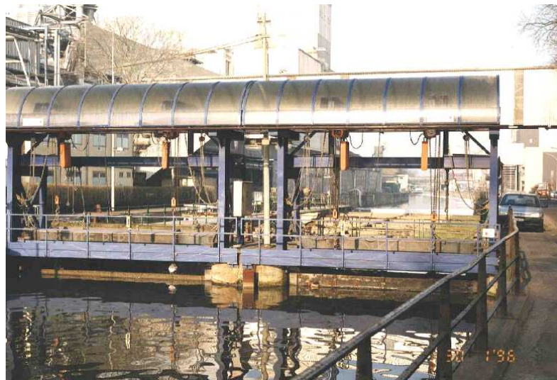
Vooraanzicht balkenstuw Aalst
