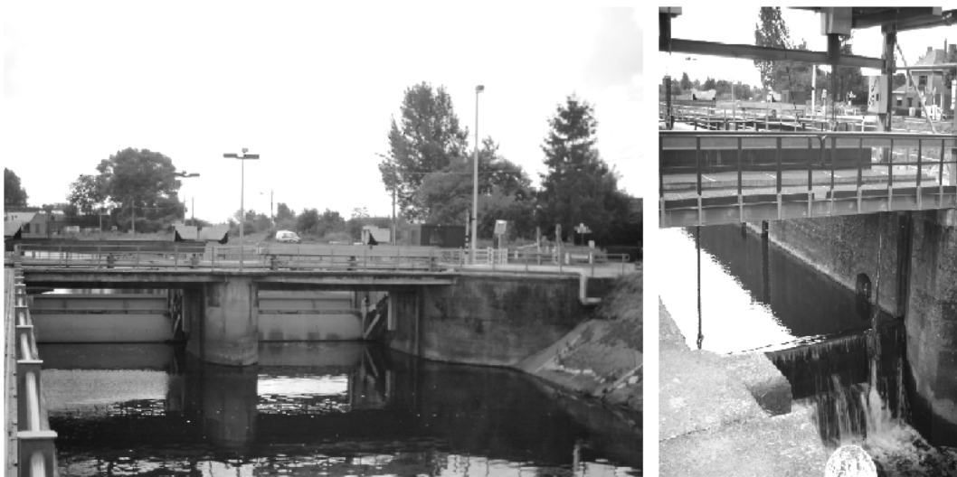
Stuw te Balgerhoeke (met de balkenstuw in de sluis)
