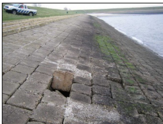
Figuur 5. Voorbeeld van schade (Bron: project zeeweringen, 2007).
