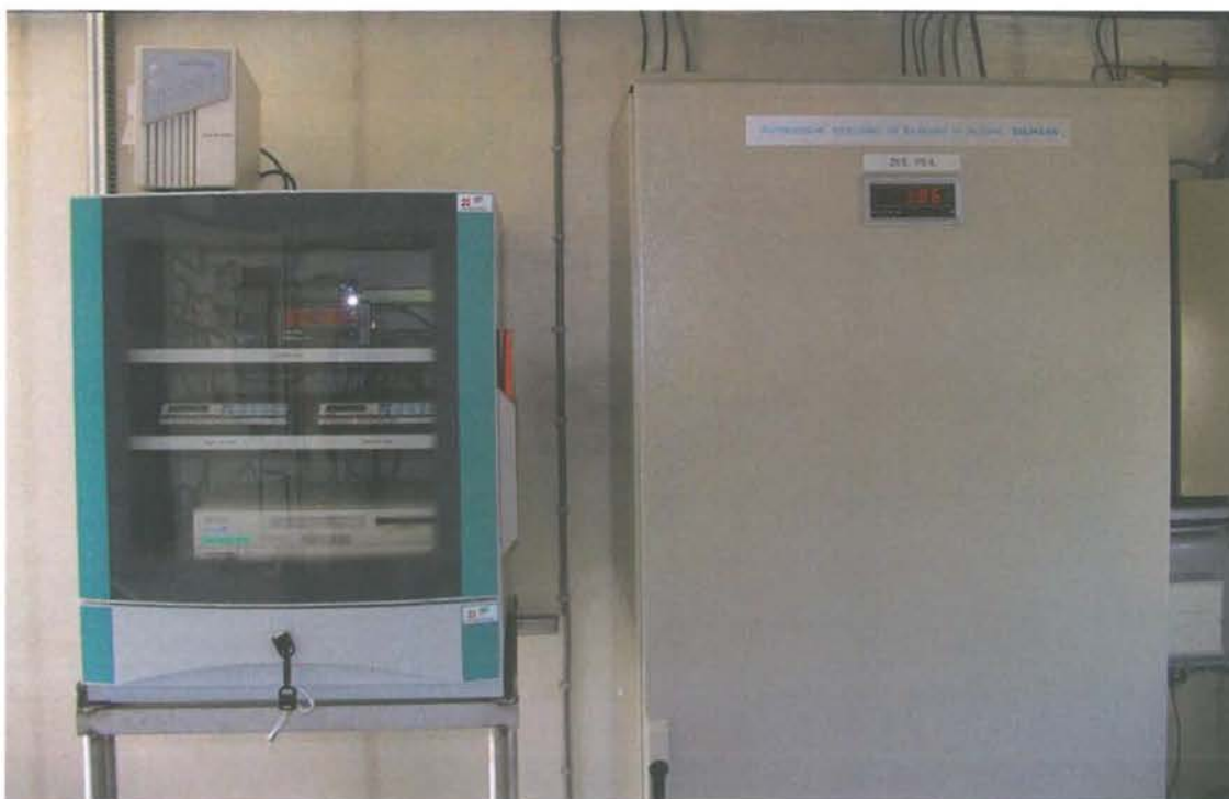
Teletransmissie & telecommunicatie te Oostende
