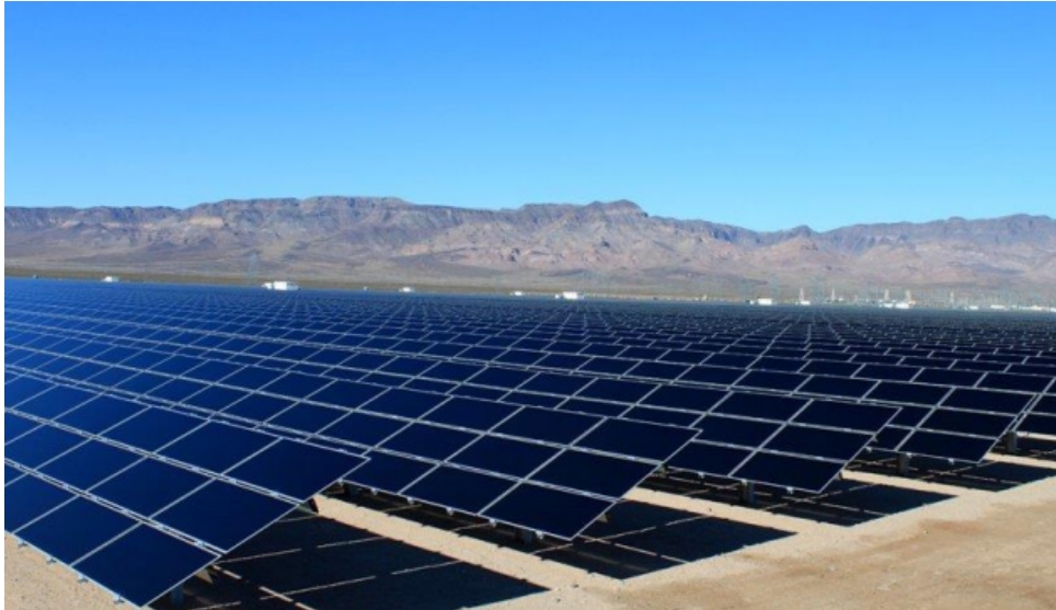
Figura 2.10: Campo fotovoltaico “Copper Mountain Solar Farm”, en EEUU
