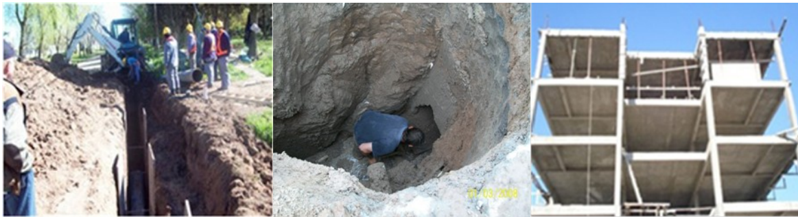
Red de desagües cloacalesGuernica, Provincia de Buenos Aires.PH en altura – Cdad. de La Plata (Arg.)
