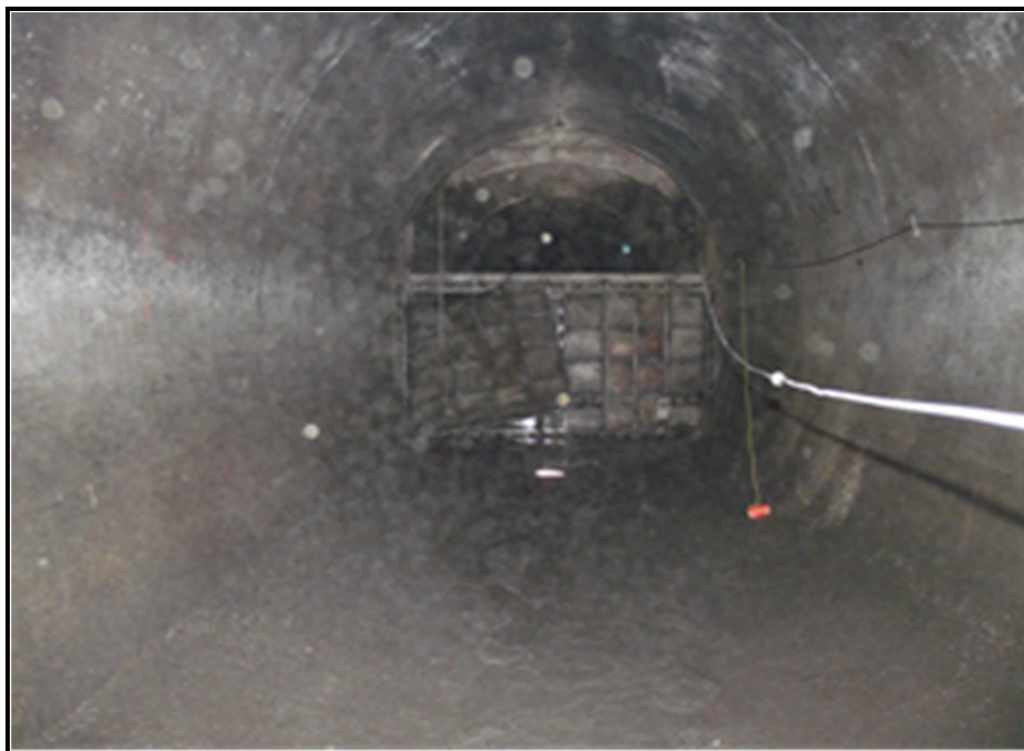
Figure 2.5 Aval du point de débordement
