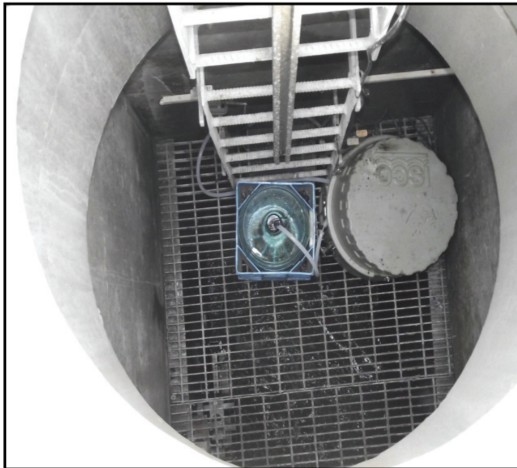
Figure 2.4 Regard d'accès au point de surverse
