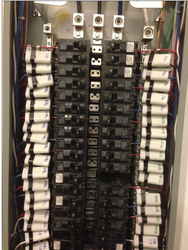
Figure 1.7 Capteurs de courant installés dans un panneau de disjoncteurs
