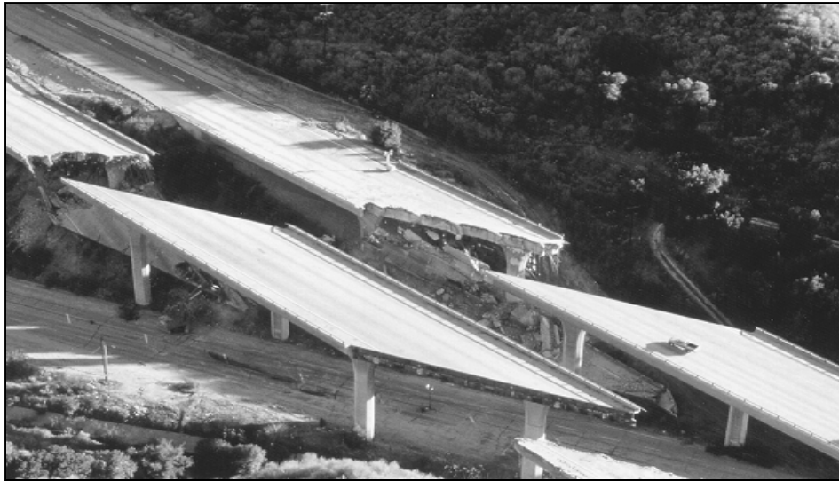
Figure 1.19 L'effondrement du pont Gavin Canyon Undercrossing Northridge 1994 Tirée de Chen et Duan (2003, p. 2-11)
