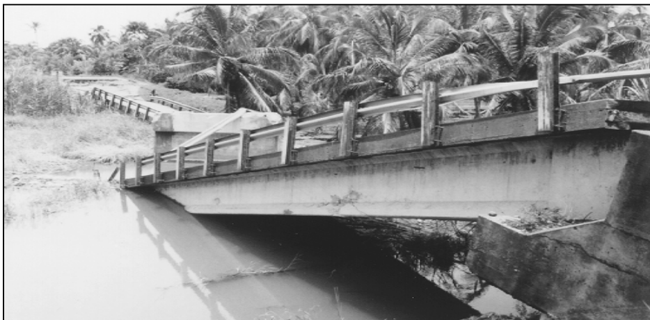
Figure 1.18 L'effondrement du pont Rio Bananito, Costa Rica 1991 Tiré de Chen et Duan (2003, p. 2-11)
