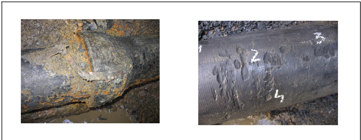
Figure 5.61 Phénomène de graphitisation de la conduite- Rue AR-FX1.
