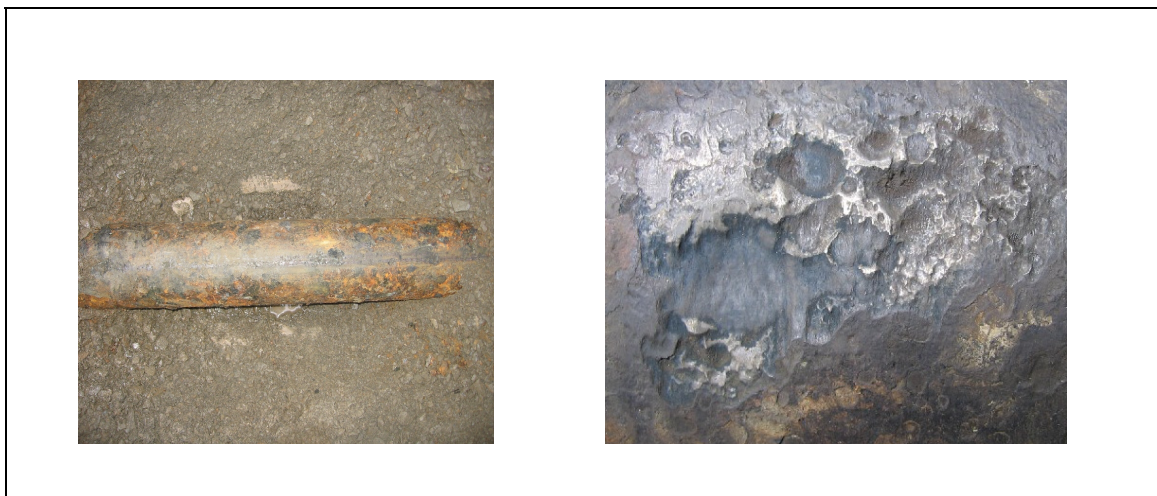
Figure 5.67 Phénomène de graphitisation de la conduite- Rue AR-DX1.
