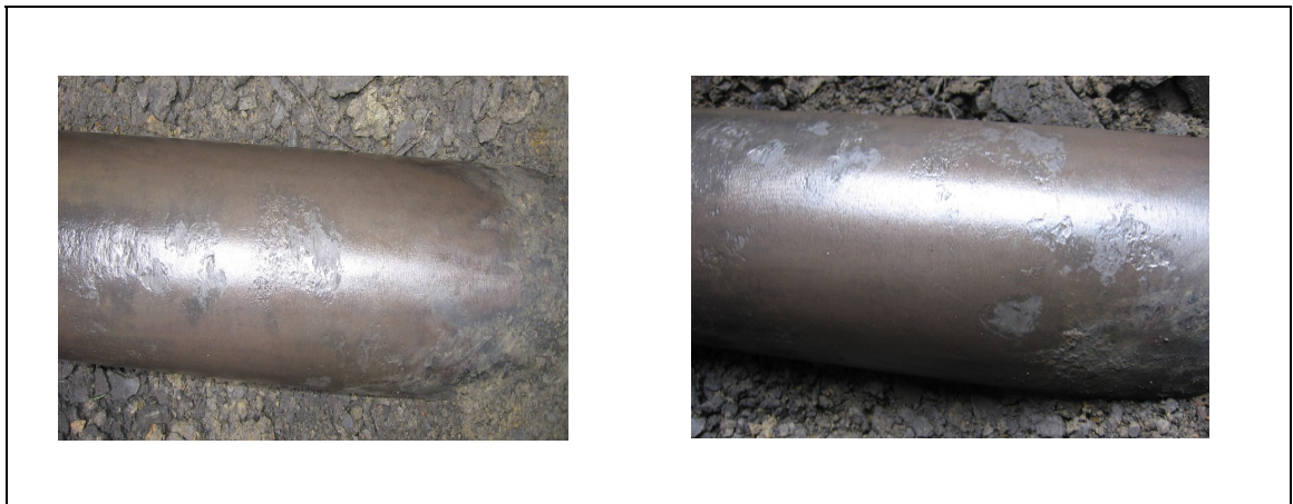
Figure 5.52 Phénomène de graphitisation de la conduite- Rue AR-AX1.
