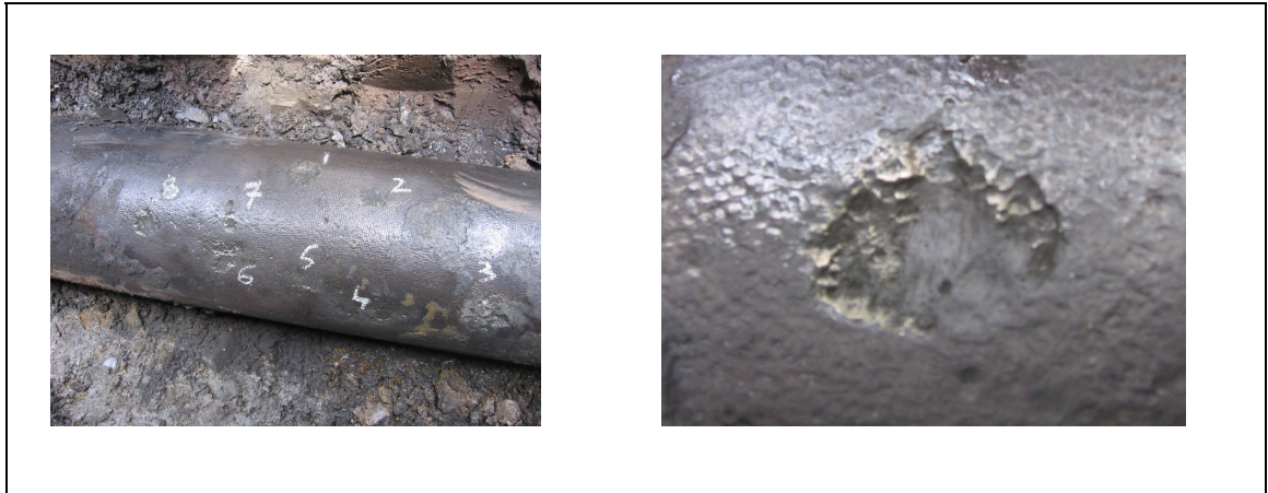
Figure 5.64 Phénomène de graphitisation de la conduite- Rue AR-FX2.
