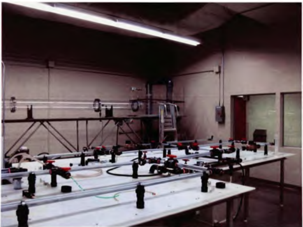
Figure 3.1 Le montage du réseau dans le laboratoire de PETS.
