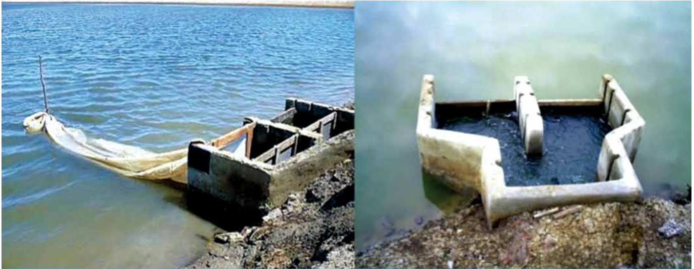
Figura 52a. Estructuras de entrada (izquierda) y de salida (derecha) en un estanque de cultivo de una granja camaronera, en las cuales se mantienen filtros de malla, bolso y entablado para evitar el ingreso de organismos foráneos y la fuga de camarones durante el ciclo de producción. Fotos cortesía del Ing. C. Lara.
