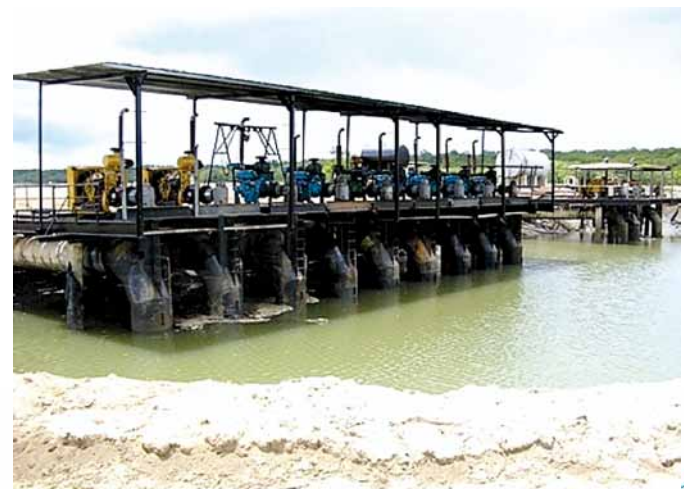
Figura 16. Estación de bombeo de una granja camaronera con bombas axiales. Foto cortesía del Dr. J. Cuéllar-Anjel.
