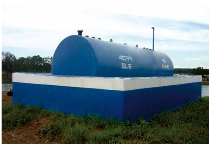
Figura 17. Depósito de combustible debidamente rotulado y con una fosa de seguridad para contener derrames. Foto cortesía del Ing. C. Lara.
