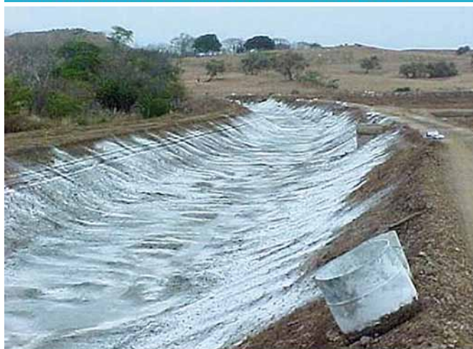
Figura 31b. Canal reservorio que ha sido encalado manualmente, como una de las buenas prácticas de una granja camaronera pequeña. Foto cortesía del Ing. C. Lara.
