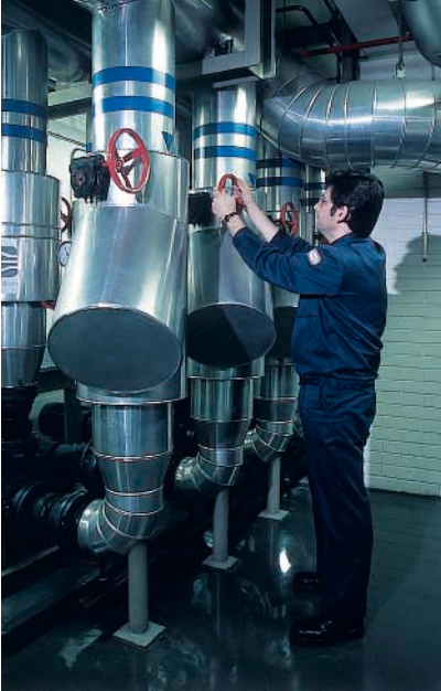
■ Personal de mantenimiento de TMI
