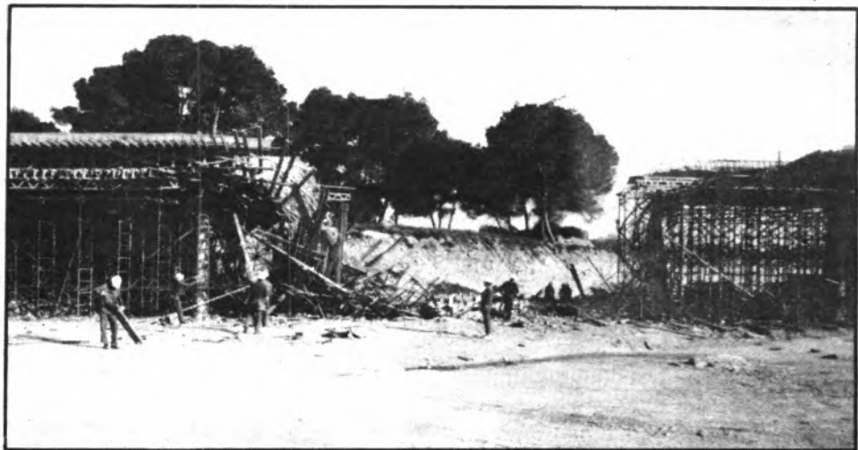
El pont de la nova carretera de Lluçmajor a l'altura de Ses Cadenes se va esbucar quan hi posaven el ciment. Un desastre que costarà una punta de milions a l'empresa constructora alhora que retardarà les obres.
