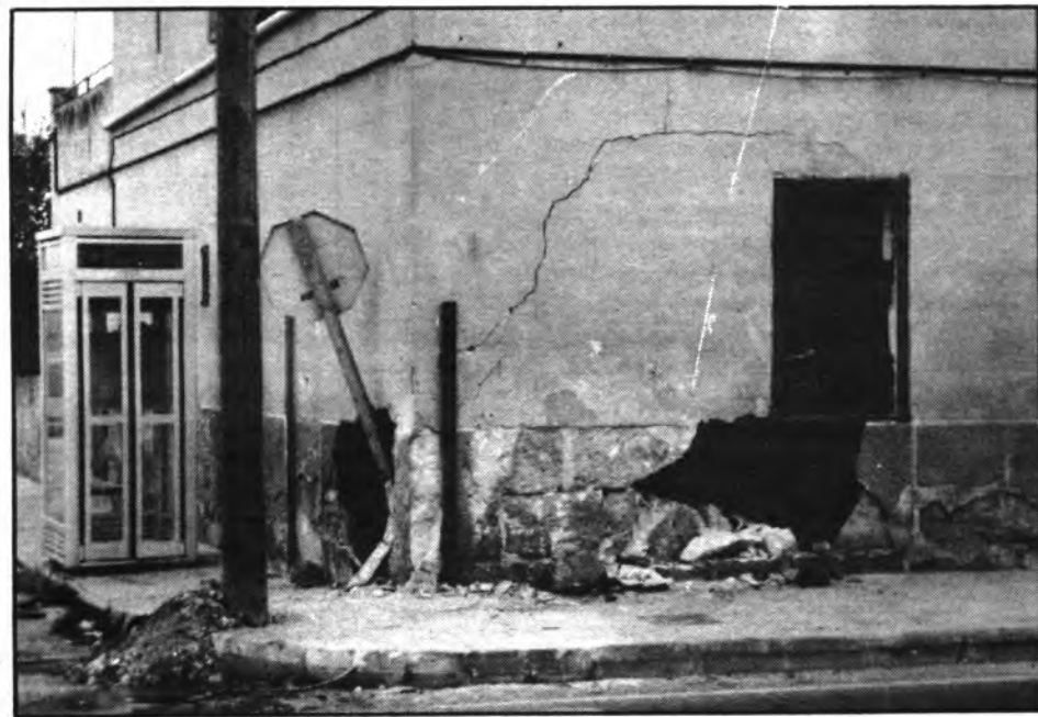
La cantonada d'aquesta casa a la Plaça dels Molins de Vent de Sa Casa Blanca va quedar com mostra la fotografia a causa de l'impacte d'un cotxe. Afortunadament ningú dormia dins el cuarto de la cantonada a les dues de la matinada, hora en què se va produir el fet.
