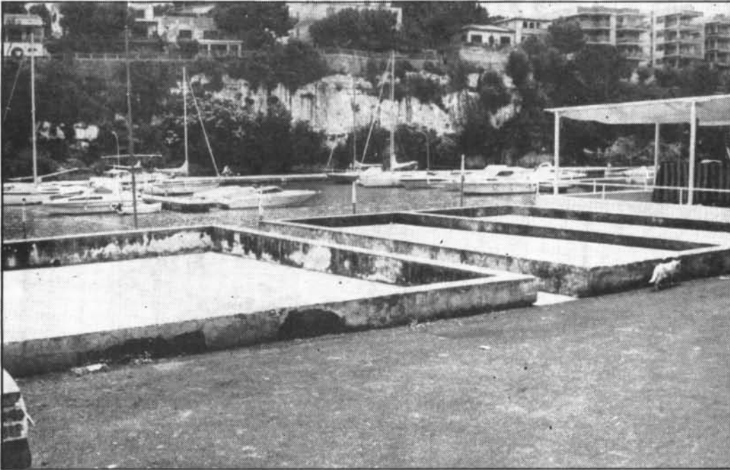
Algunas de estas terrazas están a punto de derrumbarse, lo que representa un grave peligro público
