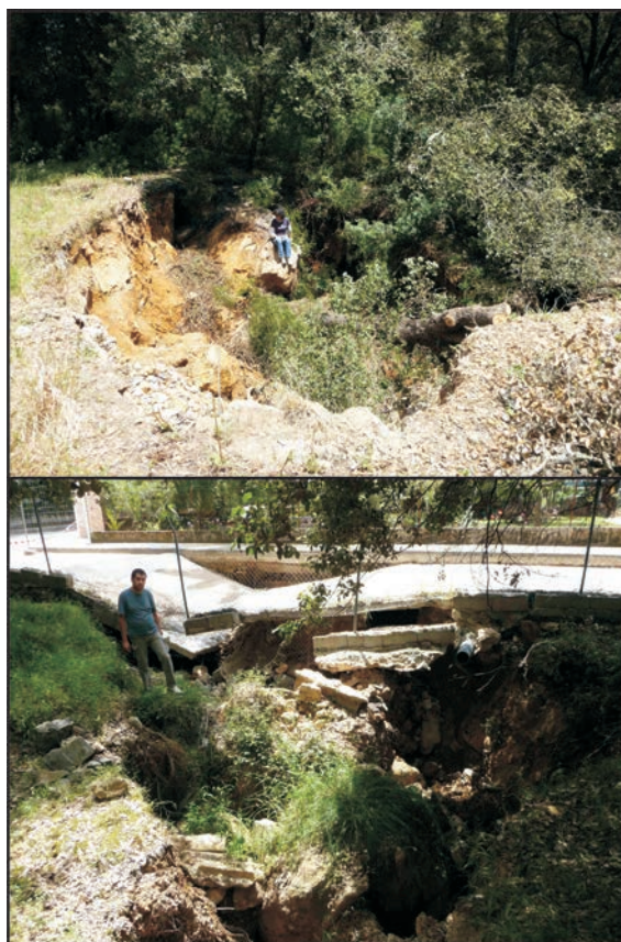
Figura 14: Dos dels col·lapses que s'han obert a la urbanització de Crestatx. A la imatge superior s'observa un gran col·lapse que afecta a una zona de conreu. A la imatge inferior es mostra un col·lapse de més petites dimensions però que afecta a una infraestructura de la urbanització (carretera) i que es localitza a poca distància dels habitatges.
