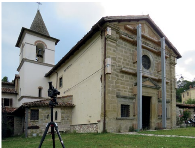
Figura 1. Puntellamento della facciata del Santuario di Santa Maria delle Grazie a Varoni.
