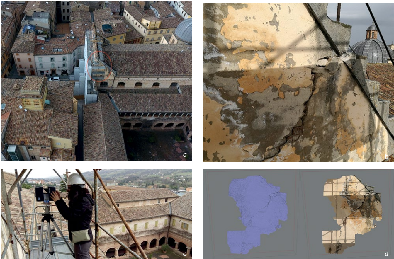
Figura 3. Lesioni in corrispondenza dei contrafforti del fronte: (a) vista aerea con ponteggi del fronte che raggiungono l'area della lesione; (b) una vista ravvicinata della lesione; (c) Giulia Sammartano, membro del team DIRECT, nella fase di programmazione della scansione laser sul ponteggio; (d) modello 3D geometrico e con texture dell'area della lesione.
