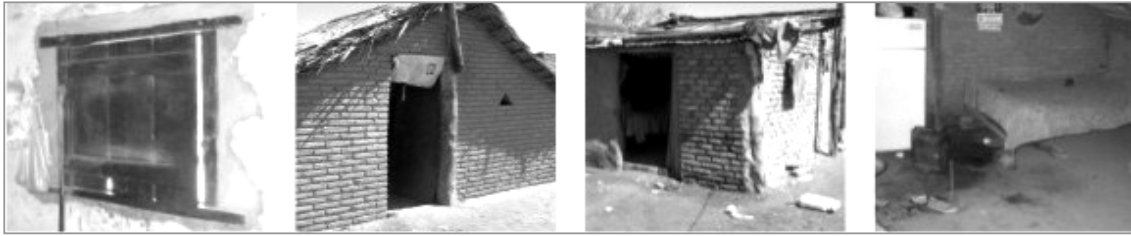
Figuras 8, 9, 10 y 11: Aberturas reducidas o mal dispuestas.
