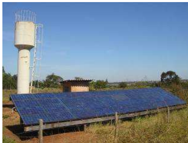
Figura 5: Sistema fotovoltaico de bombeamento do PRODEEM revitalizado com a configuração SFB-CF, Pontal do Paranapanema-SP, Brasil.
