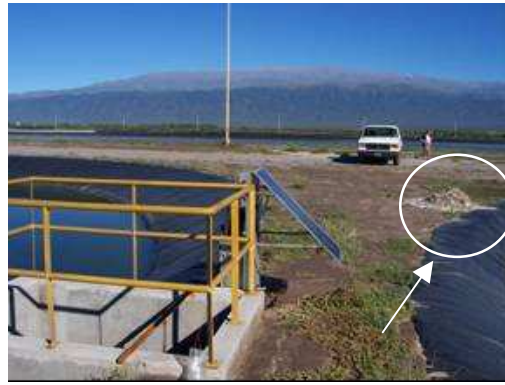
Figura 4. Disposición de sólidos extraídos de la laguna anaeróbica, Módulo 3.
