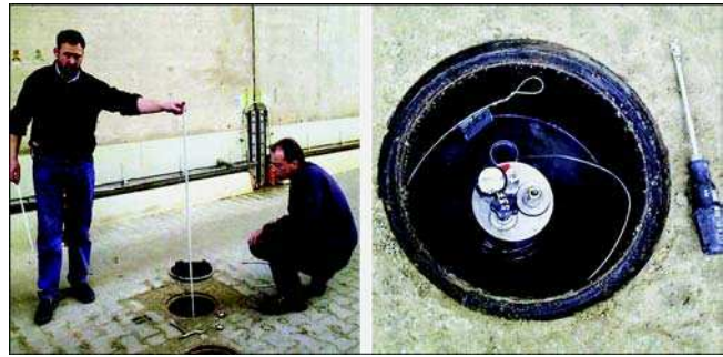
Bild 3.6: Messstellenkopf der artesischen Grundwassermessstellen und Grundwasserstandsmessung mittels aufgesetztem Plexiglasrohr
