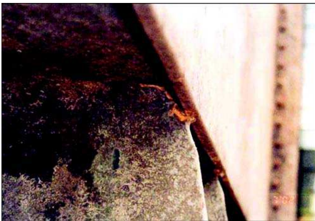
Bild 2.8: Ermüdungsfestigkeitsriss am Untertor der rechten Schleuse Neckarzimmern
