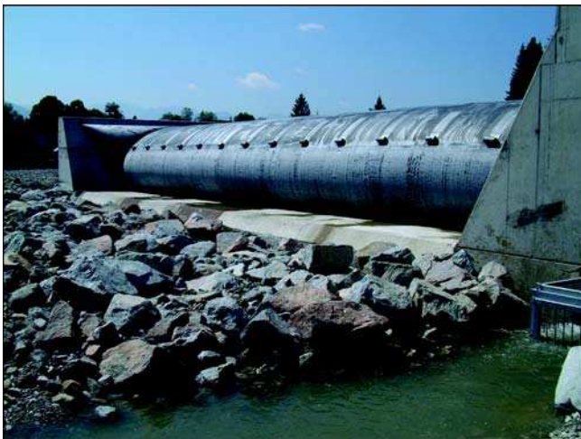
Bild 7.15: Wasserkraftanlage Lechbruck/Lech (wassergefüllt)
