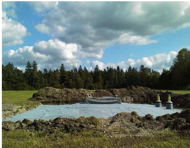
Bild 9: Abdichtung des Brunnenumfeldes (Beispiel einer Baumaßnahme in einem Grundwasserfeld mit hochpermeablen Schottern ohne mächtige Grundwasserüberdeckung) inkl. der Beobachtungsmessstellen. Aus TRESKATIS (2012).
