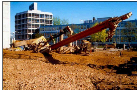
Abb. 1: Bei Bohrarbeiten 5-Zentner-Bombe angebohrt
