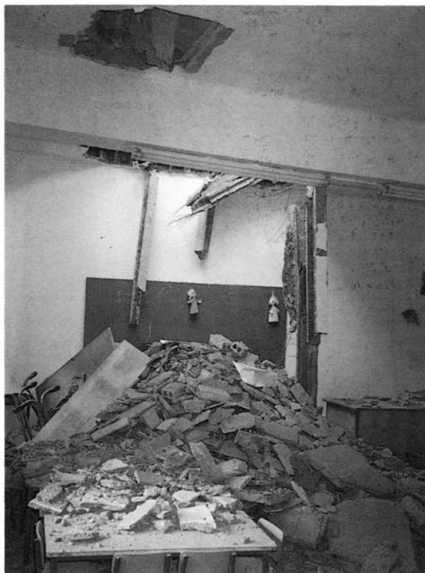
Otro aspecto del colapso de una escuela.
