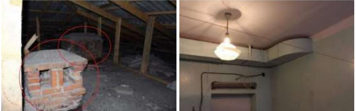
Рисунок 2.12 – Вентиляційні шахти та повітропроводи
