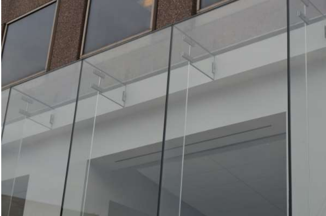
Gambar 9.28. Dinding kaca yang dipasang dengan sistem sirip kaca, namun tanpa pemegang model spider , hubungan antar kaca diperkuat dengan lem kaca dan sealant . (Sumber www.connerssales.com )
