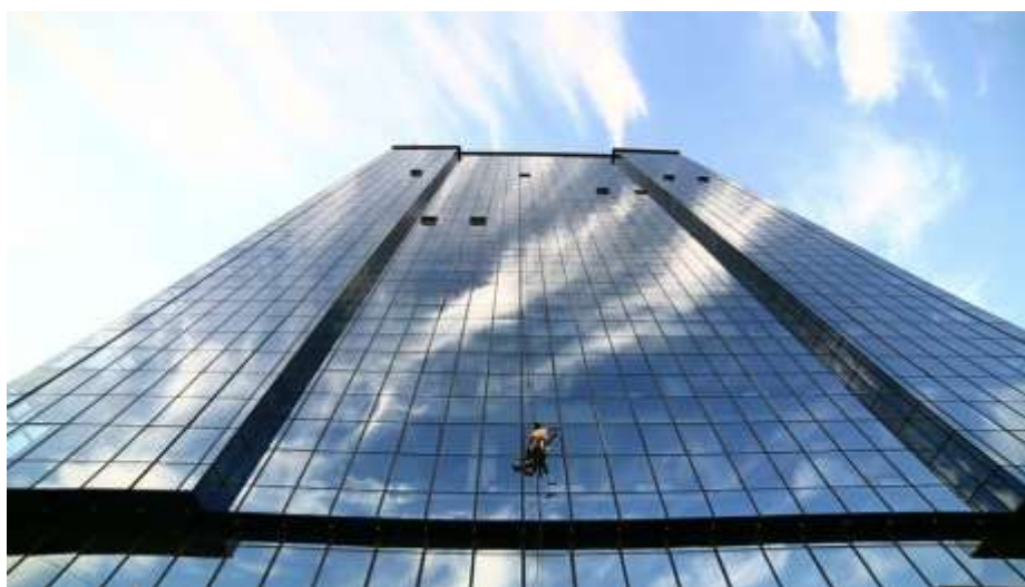
Gambar 9.41. Pekerja pembersih kaca bangunan tinggi menggunakan tali penggantung saja.
