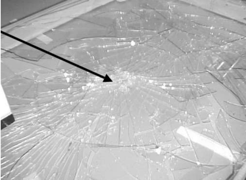
Gambar 5.20. Tampak kaca yang mengalami high energy impact , titik posisi impact terlihat jelas, retakan banyak dan membentuk radial.
