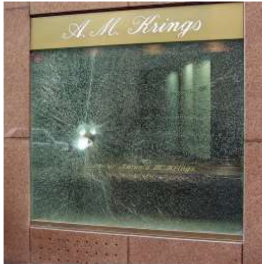
Gambar 2.41. Kaca tahan peluru di toko perhiasan, tidak pecah setelah adanya usaha perampokan. (Sumber https://en.wikipedia.org/wiki/Bulletproof_glass#/media/File:Bulletproof_glass_window_after_a_burglary_attempt.jpg )
