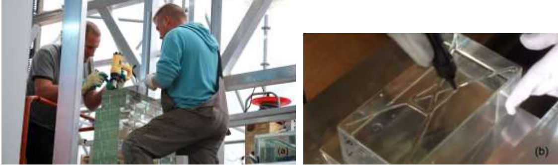
Gambar 8.10. Proses penyusunan dinding glass-brick (a) dan lem khusus Delo-Photobond untuk sambungan antar brick (b). (Sumber https://www.archdaily.cn/ )
