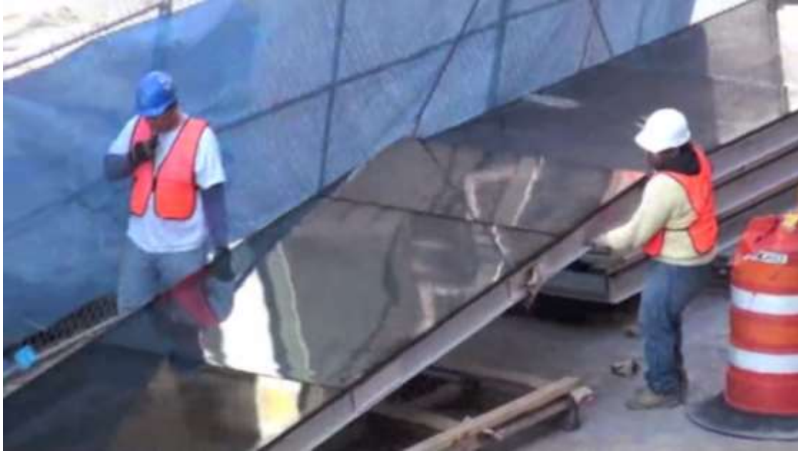
Gambar 9.33. Nampak frame berada di belakang kaca pada suatu modul kaca yang siap diangkat ke atas.
