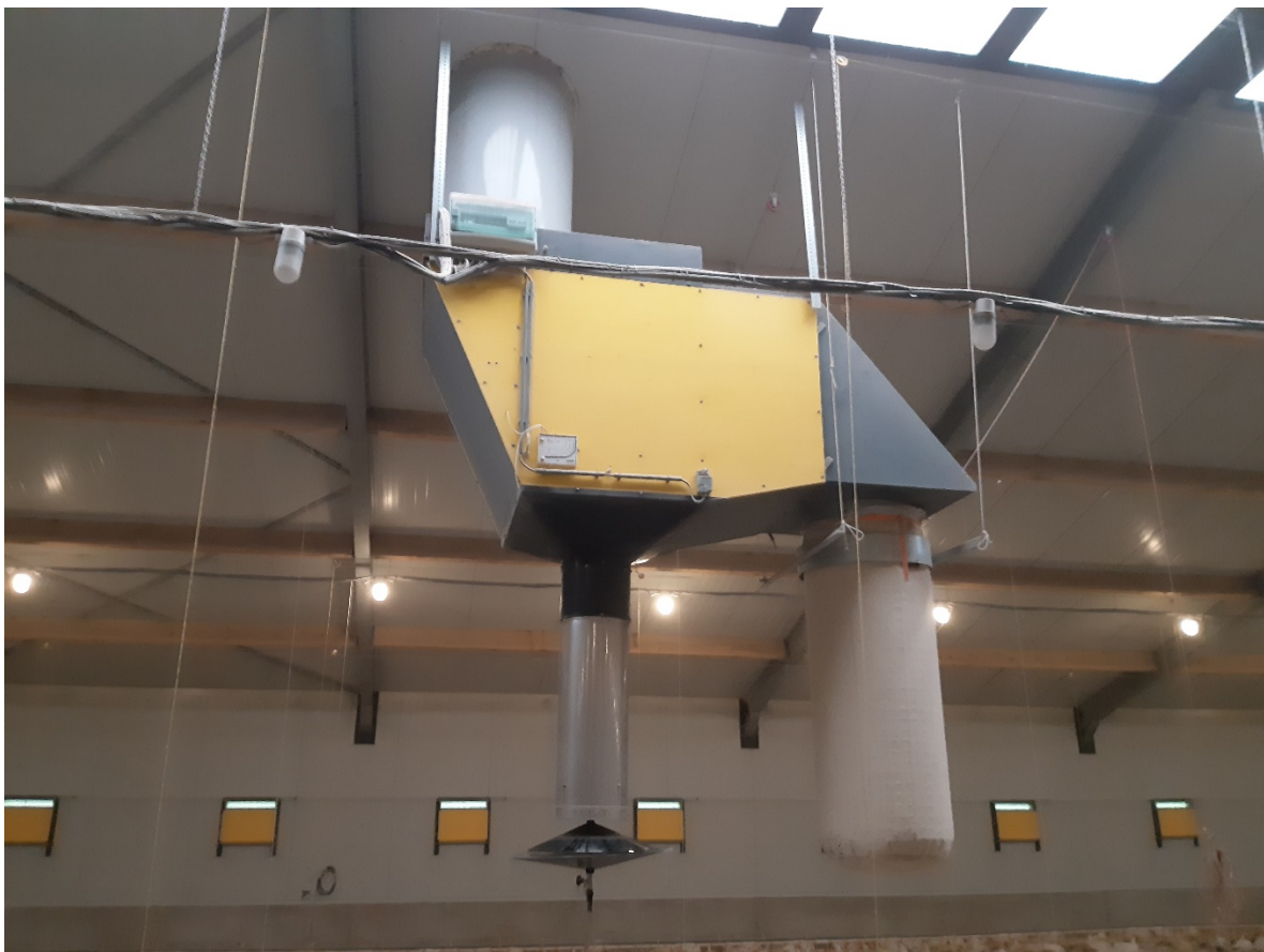
Warmtewisselaar hangend aan plafond in de stal.
