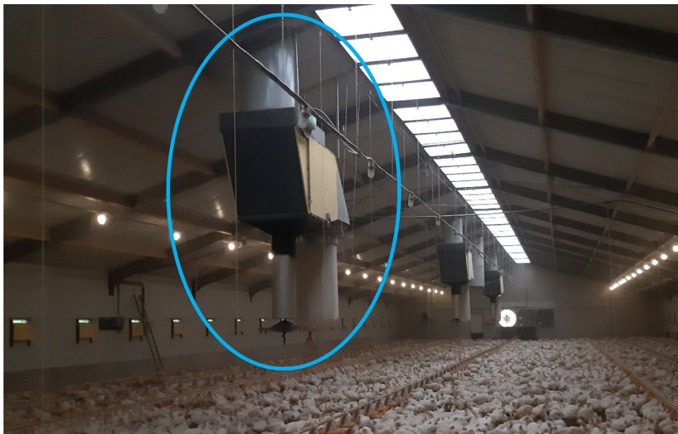
Figuur 2.1-C De warmtewisselaar in de stal waar is gemeten. Op de foto is één van de units blauw omcirkeld.
