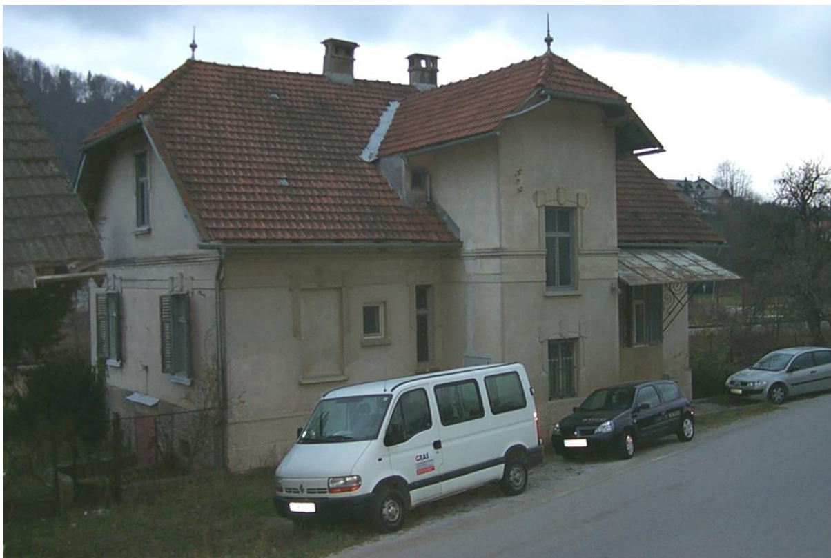
Slika 5: Prikaz zazidanega okna (vir: Fotodokumentacija ZRMK)
