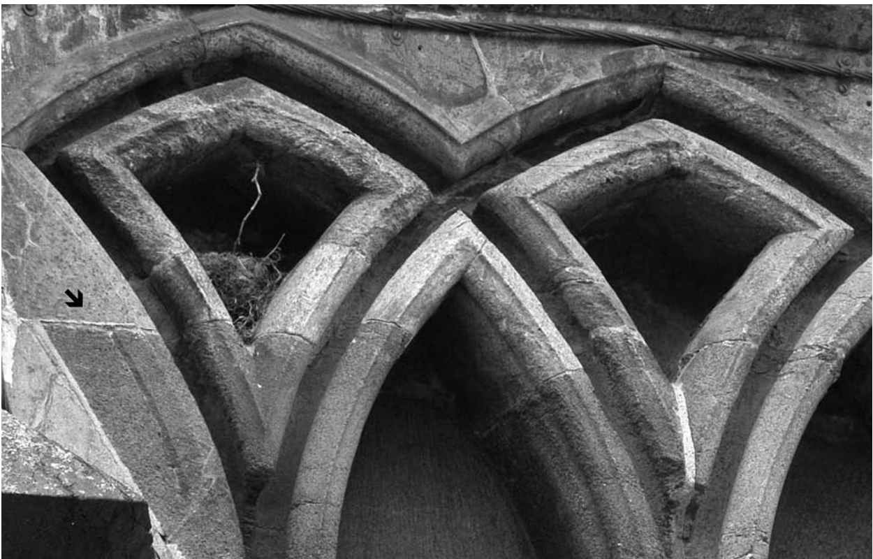
Fig. 19. Nordveggen, helt mot øst. En stor steinblokk i buefeldet har et huggespor som er en begynnelse på et profil. Buefrisen kan opprinnelig ha vært planlagt uten den rike profileringen. Foto: Kjartan P. Hauglid, 2003
