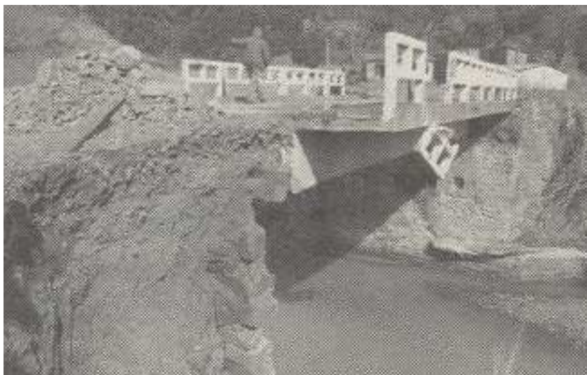
FIGURA 30 Arroio Castelhanos - Destruição da ponte e do aterro (2003) Fonte: Gazeta do Sul, 6 de agosto de 2003, p. 3.
