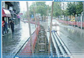
Водоводна мрежа у Сарајевској улици
