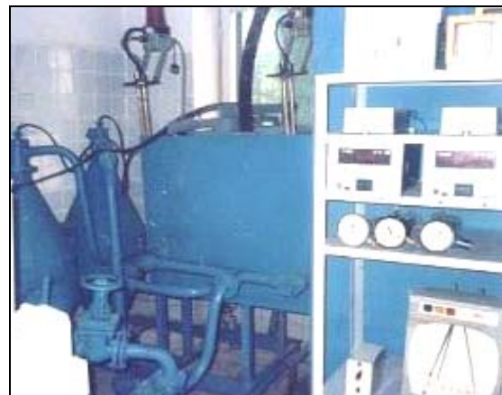
Рис. 5. Зовнішній вигляд автоматичної насосної станції
