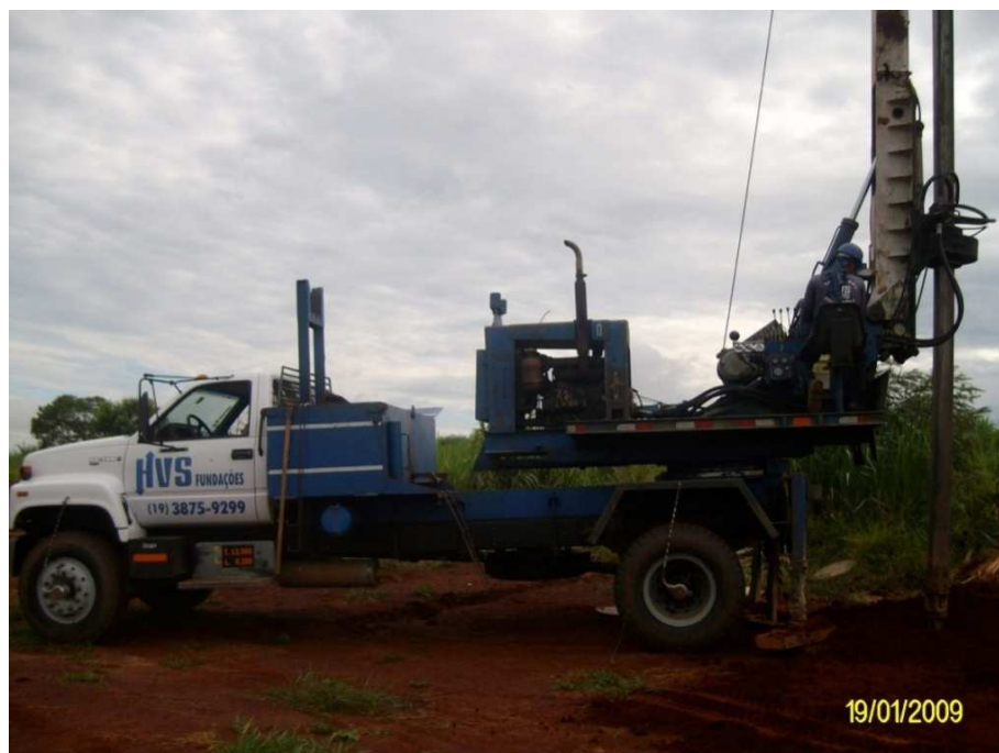
Figura 4.1. Equipamento Perfuratriz CD-20.
