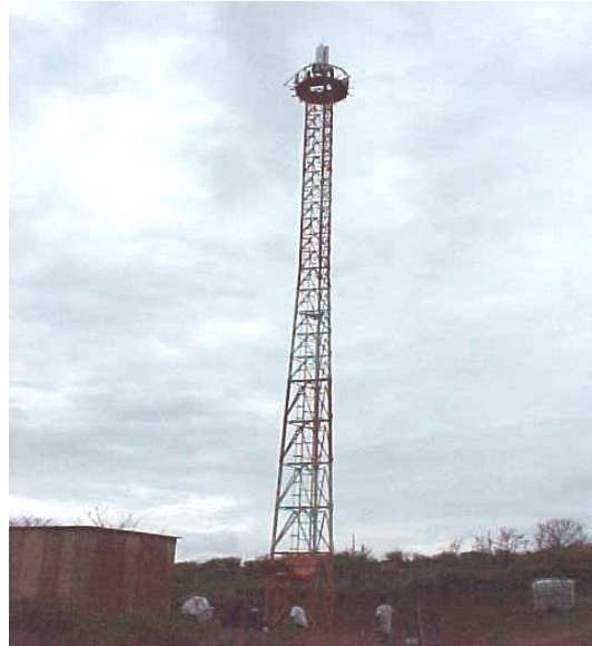
Figura 1.1: Torre de telefonia de celular instalada em Cachoeira Paulista
