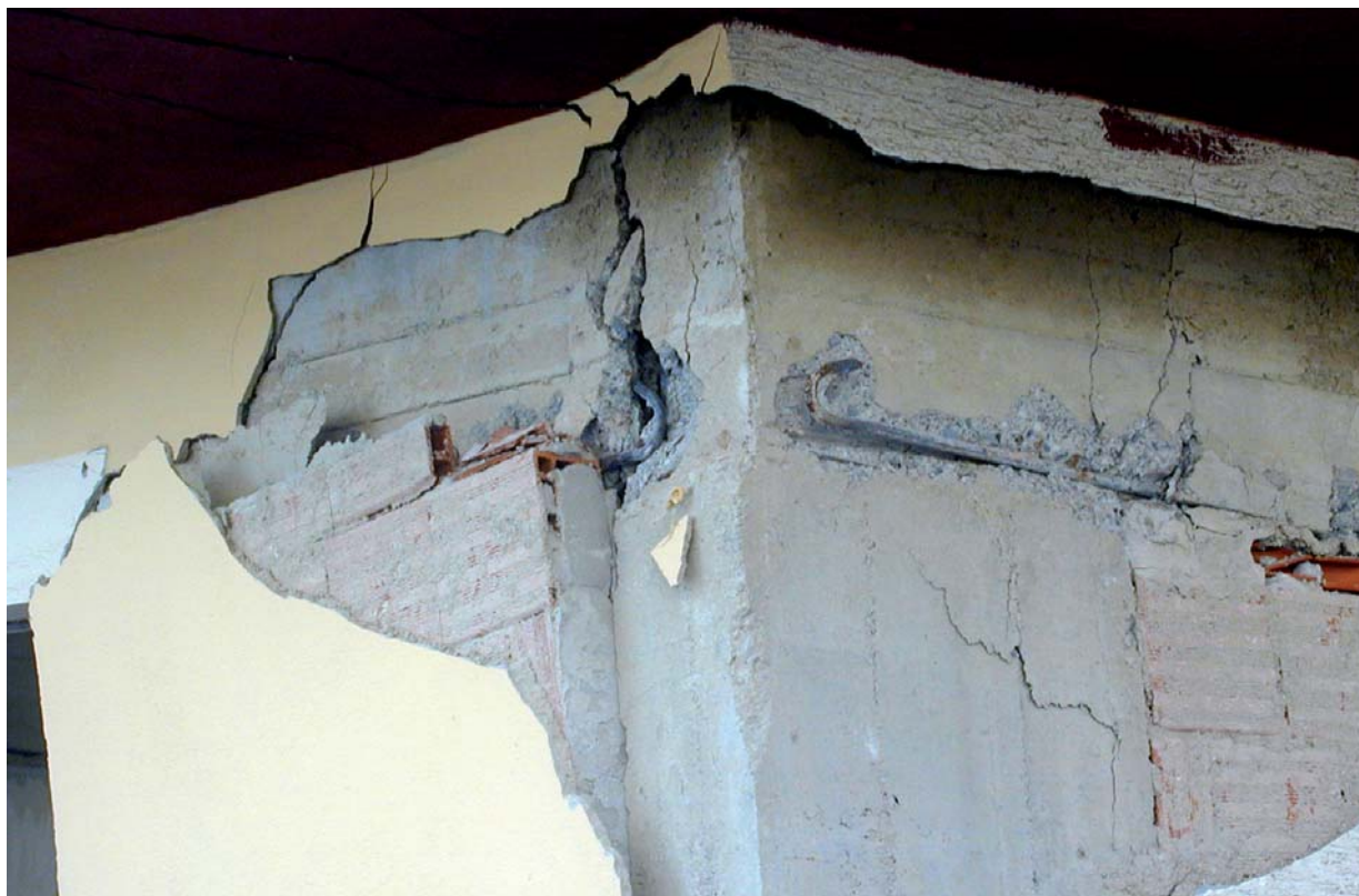
Figura 10.- Extracción de parte del armado de una viga por inadecuados anclaje y recubrimiento.
