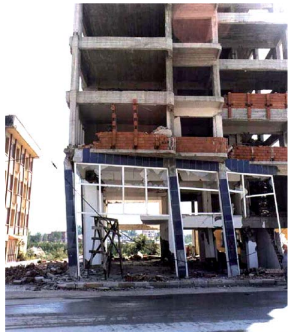
Figura 2.- Fallo dúctil de un edificio.
