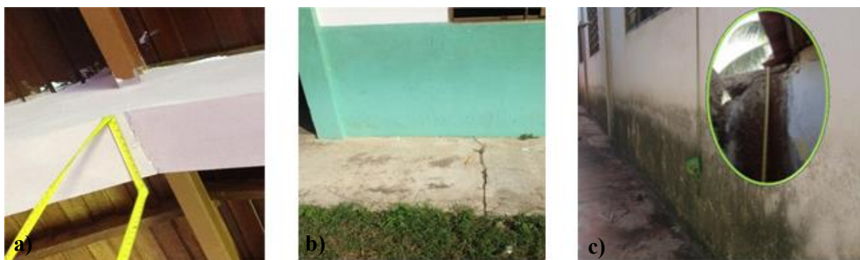
Figura 4. Fallas observadas: a) Presencia de grieta transversal inferior en la viga de carga del techo, b) Grieta transversal en la losa de piso perimetral, c) Presencia de humedades en color oscuro en paredes perimetrales
